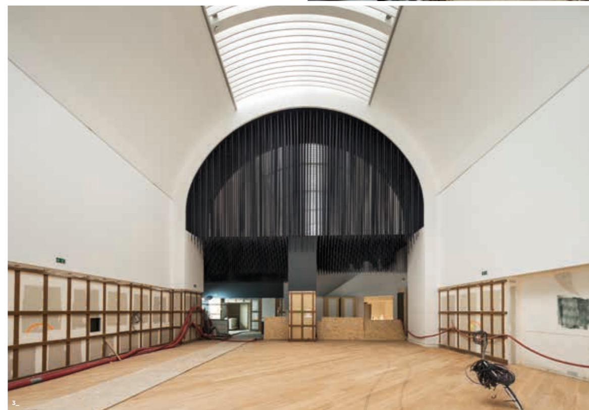
Musée national de la Marine, Paris. Chantier de rénovation. Palais de Chaillot ; Galerie Davioud. h2o architectes et Snøhetta ©Patrick Tourneboeu/OPPIC/Tendance Floue
