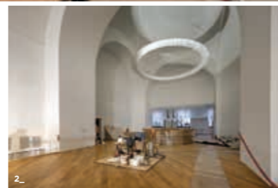
1. Musée national de la Marine, Paris. Chantier de rénovation. Palais de Chaillot ; Galerie Davioud. 11/01/2023; h2o architectes et Snøhetta. © Patrick Tourneboeuf/OPPIC/Tendance Floue 2. Musée national de la Marine, Paris. Chantier de rénovation. Palais de Chaillot. Pavillon de tête ; Galerie Davioud. 11/01/2023; h2o architectes et Snøhetta. © Patrick Tourneboeuf/OPPIC/Tendance Floue.
